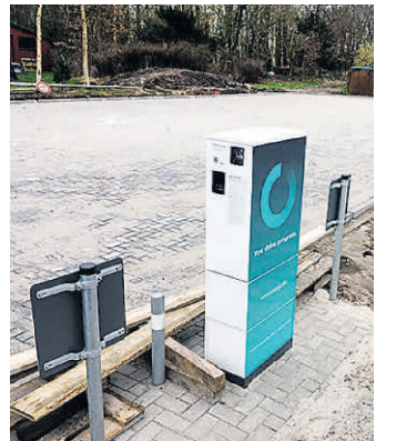
Auch eine E-Ladestation wurde installiert.
