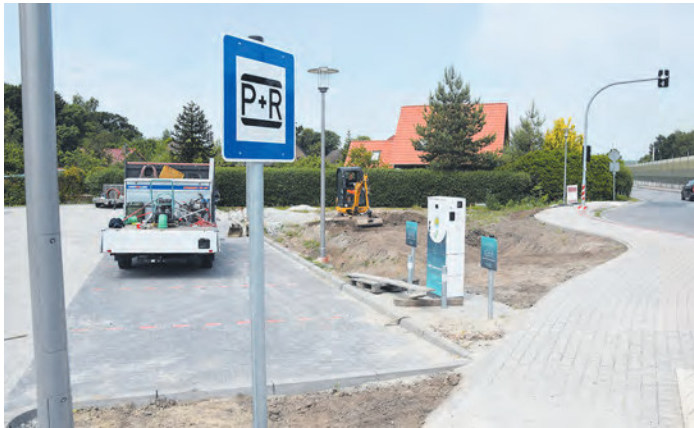
Der P+R-Parkplatz gleich neben der Station ist bereits fertig, E-Ladesäule inklusive. Noch gebaut wird unterdessen am Fahrradparkstand.
