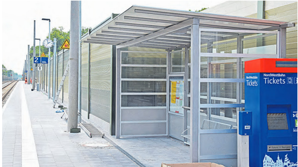
Es kann losgehen: Ticketautomat, Fahrplan, Wetterschutzdach und Bahnsteiguhr sind montiert. In vergangenen Tagen wurden letzte Vorbereitungen getroffen.
